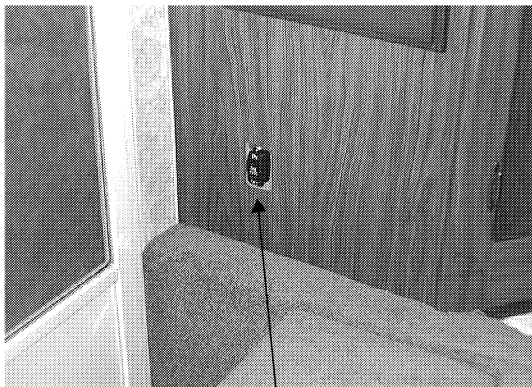
Aux. Battery Switch
